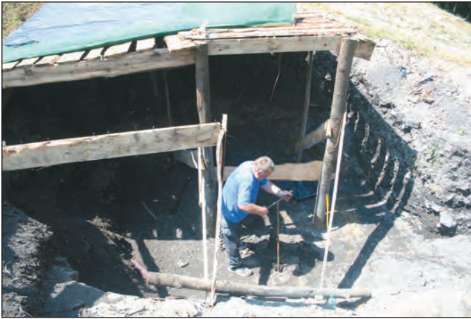
Wiercenia sondazowe w obrębie domniemanej studni na zamku muszyńskim – lato 2010 r. Przy pracy Stanisław Ziębiewicz (fot. M. Wasilewski)
